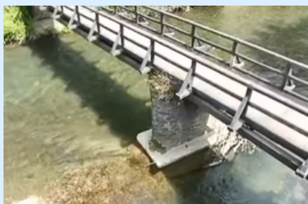
Avant la restauration
